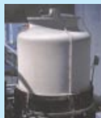
冷却塔の一例
